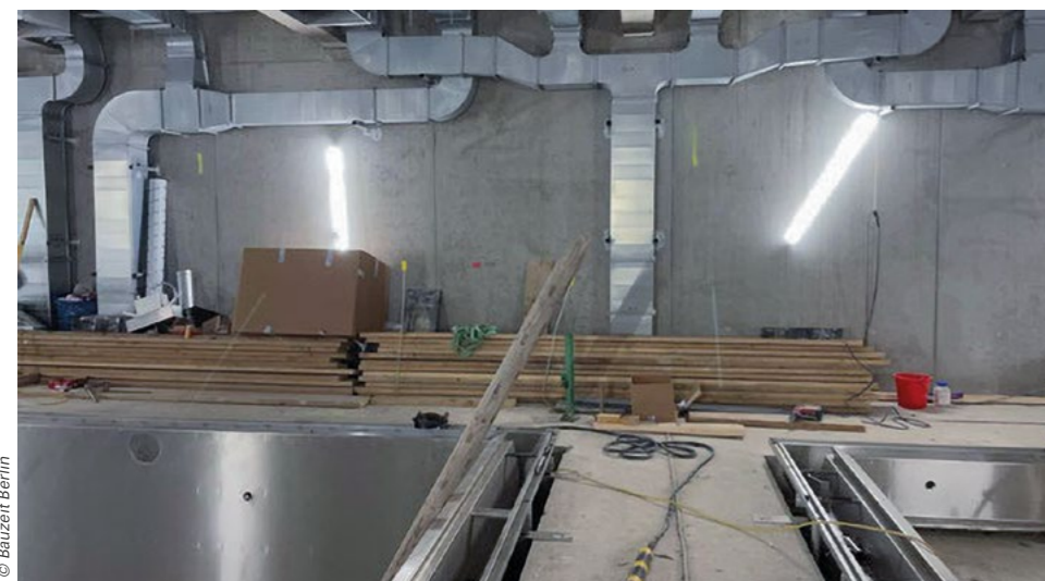
Im Sportgebäude der Charlotte-Pfeffer-Schule wurden im Dezember die beiden Therapiebecken aus Edelstahl eingebaut. Die Leitungen für Heizung und Warmwasser sind inzwischen verkleidet.
